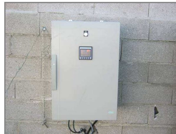
▲ Automate de contrôle
