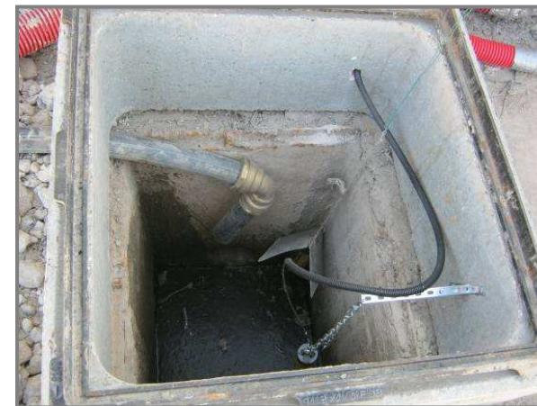
▲ Sonde de mesure dans le regard du rejet
